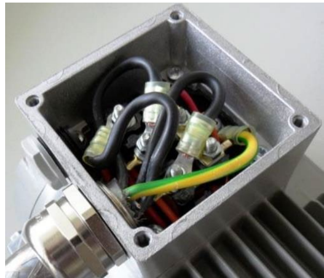
Abb. 33: Verdrahtung am Motoranschlusskasten
